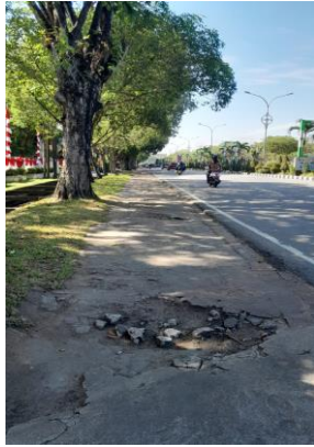
Gambar 3.5. Kerusakan di Pedestrian (Sumber: Penulis, 2023)
