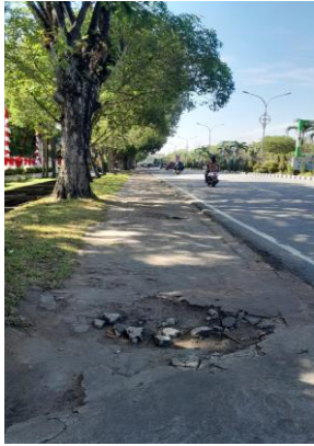
Gambar 3.5. Kerusakan di Pedestrian (Sumber: Penulis, 2023)
