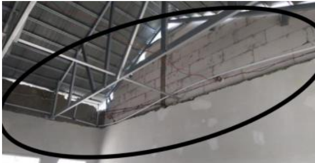
Gambar 14. Instalasi Air Bersih di Atas Plafond (Sumber : Penulis, 2022)
