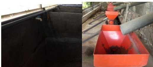
Gambar 3. 2 Proses pengaliran air pada mesin pulper (Sumber : survei, 2022)
