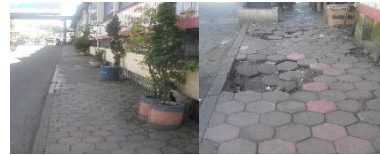
Gambar 1. Jalur pejalan Kaki/ pedestrian dan Sebagian jalur pedestrian yang mengalami kerusakan
