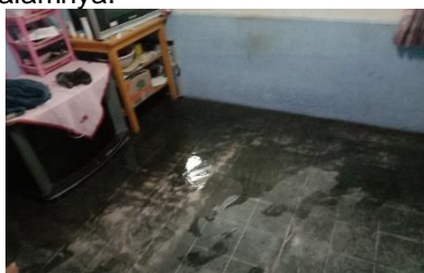
Gambar 3. Kondisi saat air masuk membanjiri area berturut : teras, gudang, ruang tidur utama, ruang keluarga dan ruang makan (Sumber: Penulis, 2020)
