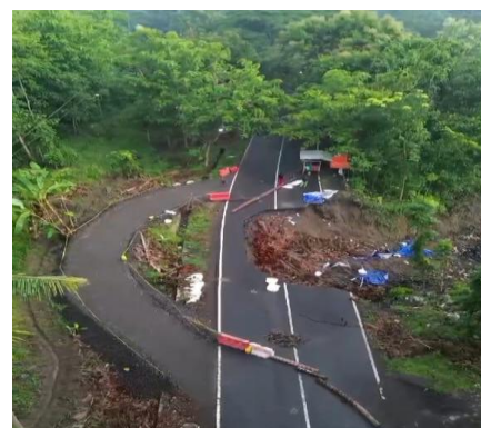
Gambar 1. Lokasi longsor dan jalan sementara
