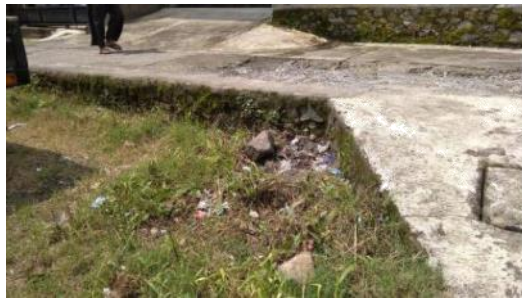
Gambar 3. Kondisi dimana banyak terdapat sampah baik di jalan maupun di tepi jalan.
