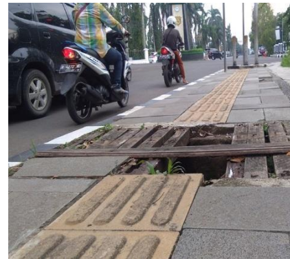
Gambar 2. kondisi dimana trotoar berlubang dan membahayakan Sumber.Dokumentasi
