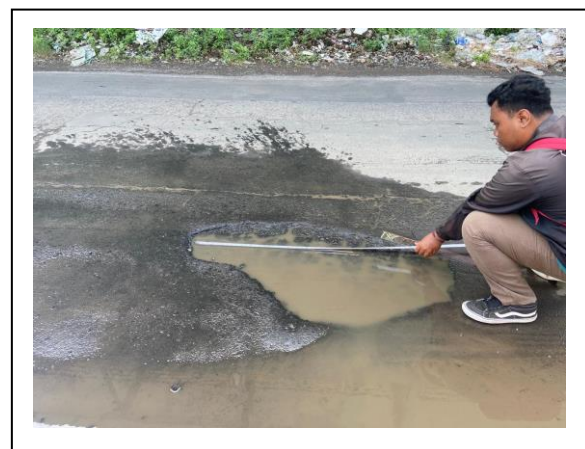
Gambar 2 Dokumentasi Pengukuran Kerusakan
